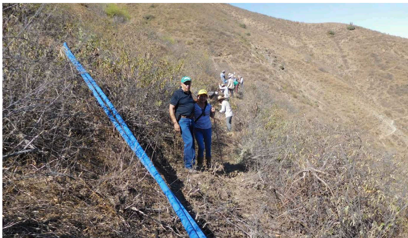
Las tuberías transportan agua potable a lo largo de muchos kilómetros
