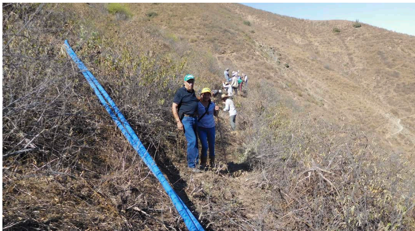
Les conduites transportent de l'eau fraîche sur plusieurs kilomètres
