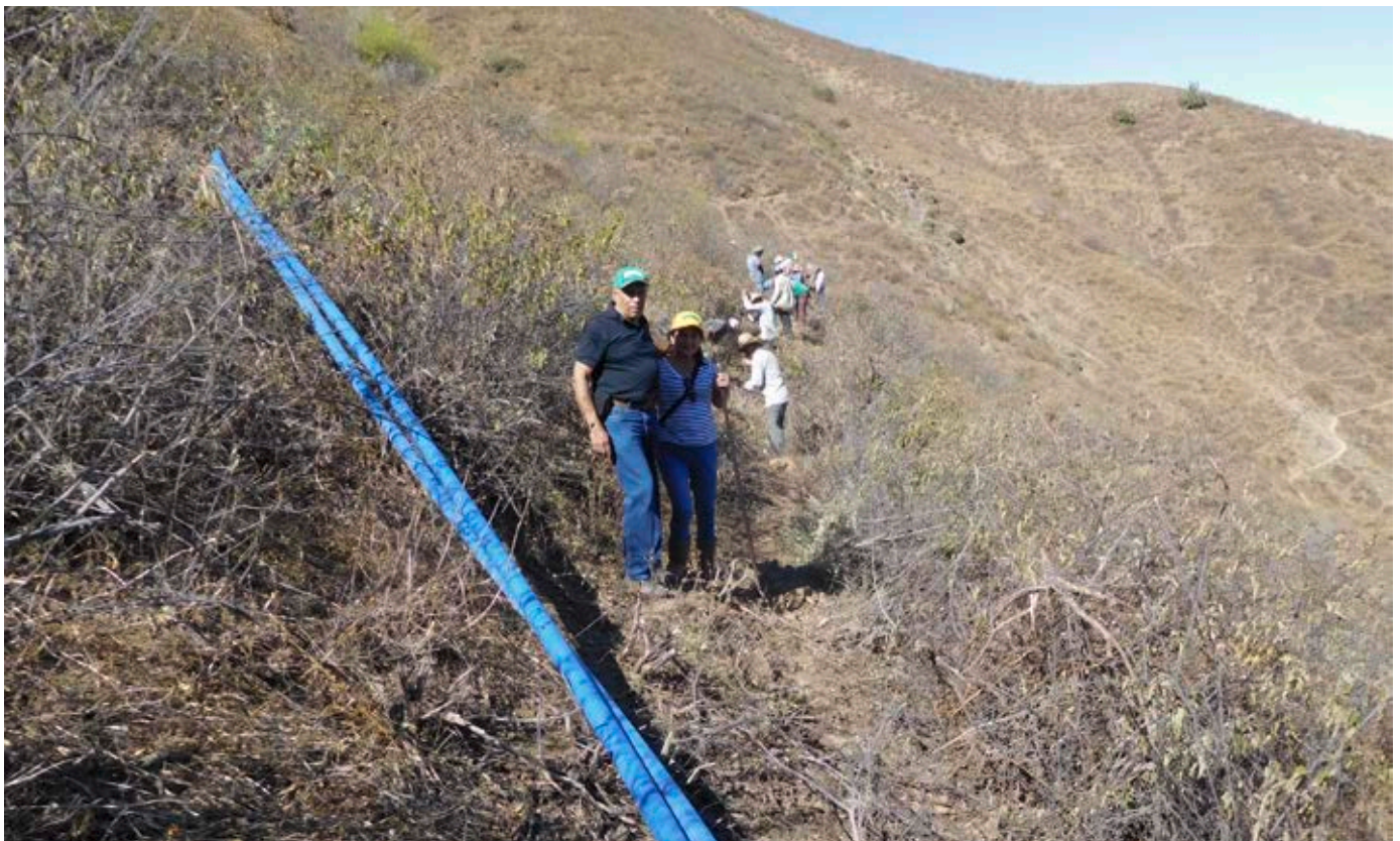
Die Leitungen transportieren über viele Kilometer frisches Wasser
